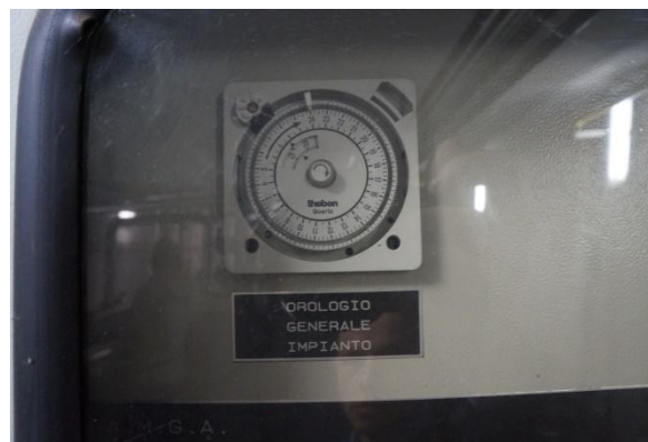
Figura 4.10 – Particolare del sistema di temporizzazione dell'impianto termico
