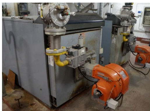
Figura 4.14 - Particolare dei generatori di calore in CT
