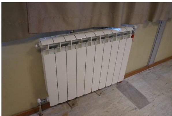
Figura 4.7 – Particolare di un radiatore installato all'interno di un ambiente di lavoro
