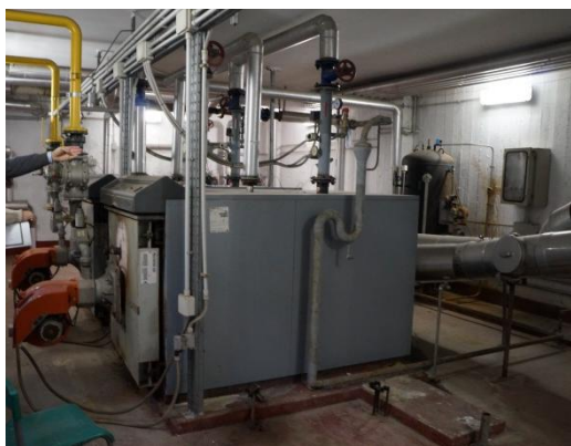
Figura 4.13 - Particolare dei generatori di calore in CT
