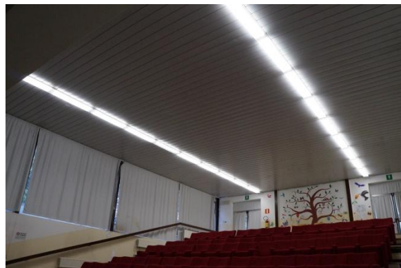
Figura 4.18 - Particolare dei corpi illuminanti ubicati nella sala spettacoli
