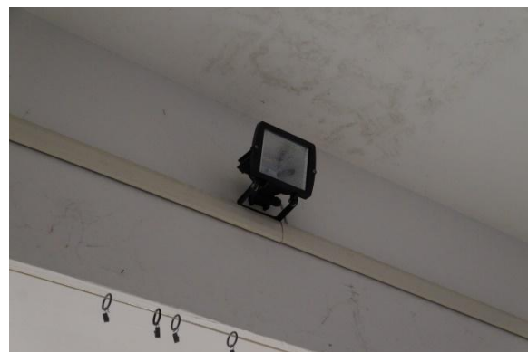
Figura 4.20 - Particolare di un proiettore alogeno ubicato all'interno della sala spettacoli
