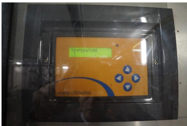
Figura 4.9 - Particolare della centralina di regolazione in Centrale termica
