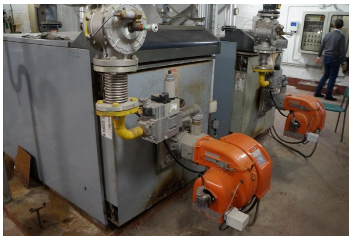
Figura 8.3 – Particolare generatore di calore esistente
