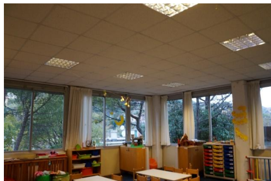
Figura 4.16 - Particolare dei corpi illuminanti ubicati nelle aule della scuola materna Arcobaleno
