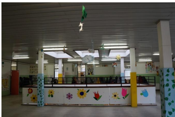
Figura 4.19 - Particolare dei corpi illuminanti ubicati nelle zone di circolazione interna
